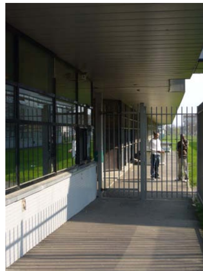
Photo 5 : SAS d'entrée avec une caméra visant à filtrer les entrées
