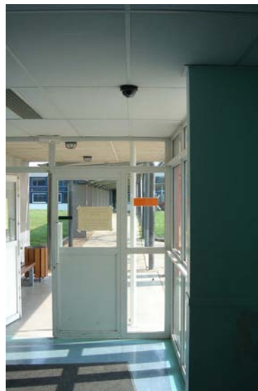
Photo 7 : caméra dôme dans un couloir d'établissement
